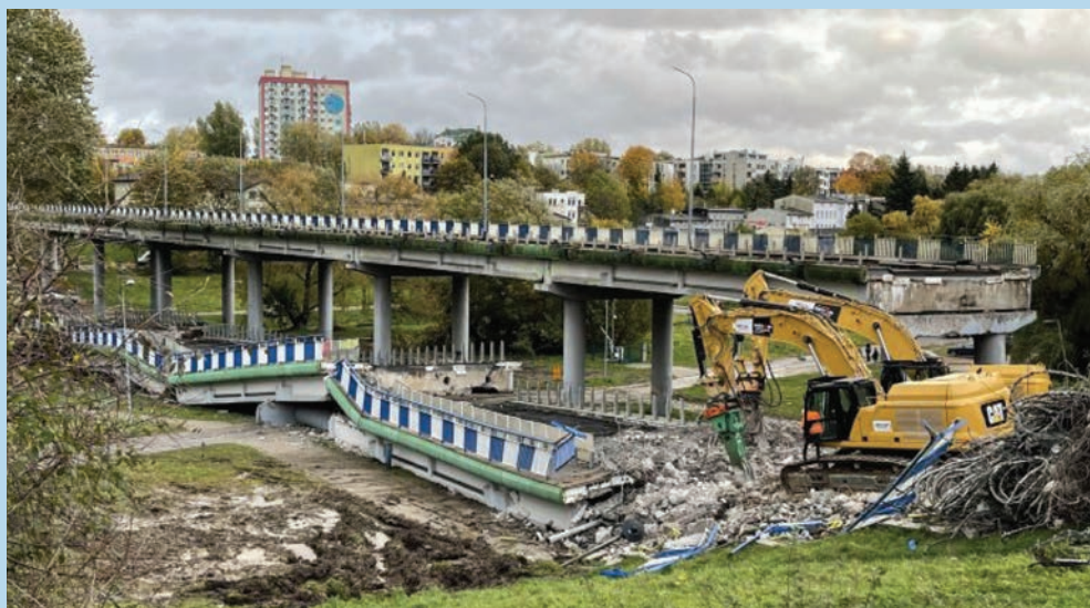
Zdj. 2. Katastrofa wiaduktu w Koszalinie w 2021 r. (fot. prk24.pl).
